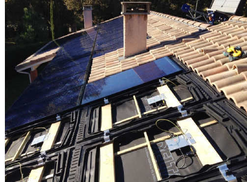
Exemple d'installation en IAB. Crédits : AIS
