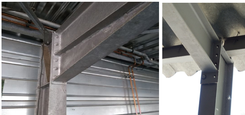
Illustrations de poteaux de portiques métalliques. Exemple de malfaçon à droite : le poteau n'est pas boulonné à l'arbalétrier. Crédits : AIS
